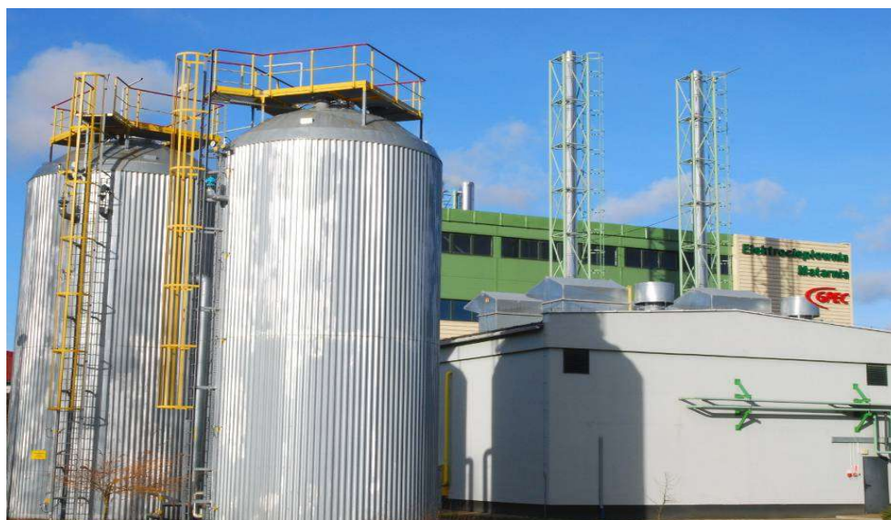
Rysunek 40 Dwa bufony ciepła o całkowitej pojemności 300 m 3 umożliwiające elastyczną produkcję ciepła przez układ kogeneracji w EC Matarnia należącej do spółki GPEC.
